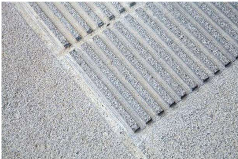
Dale tactile pentru ghidare și orientare nevăzători
