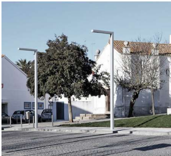
Corpuri de iluminat stradal
